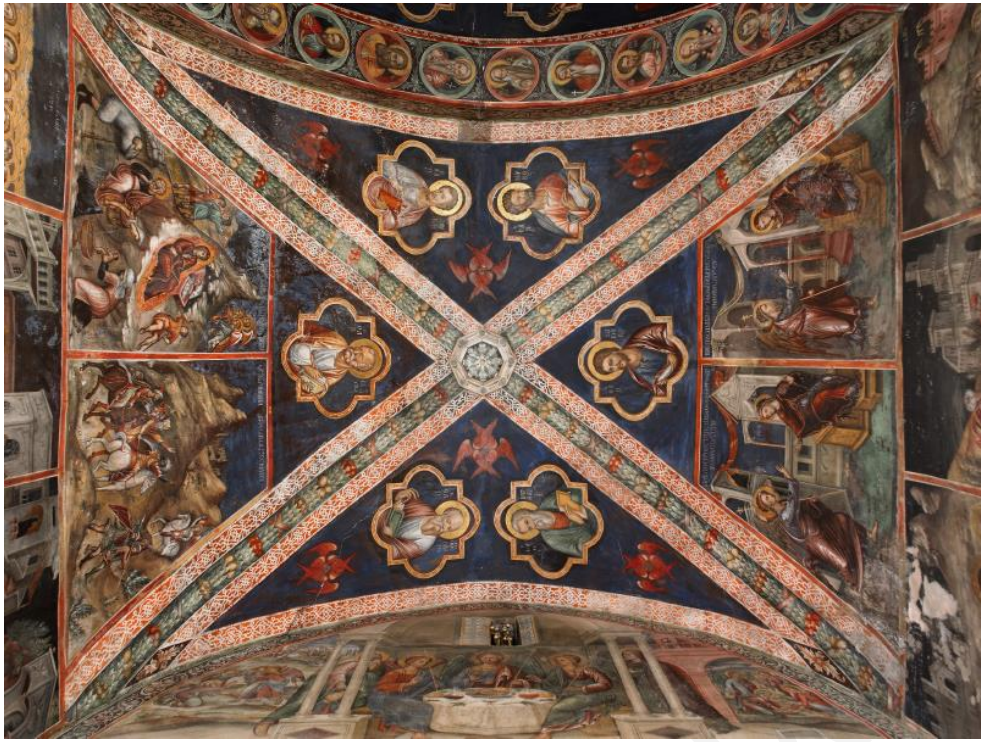
17. Καλοπαναγιώτης, Μονή Αγίου Ιωάννου Λαμπαδιστού, Λατινικό Παρεκκλήσι, άποψη καμάρας οροφής προς τα ανατολικά
