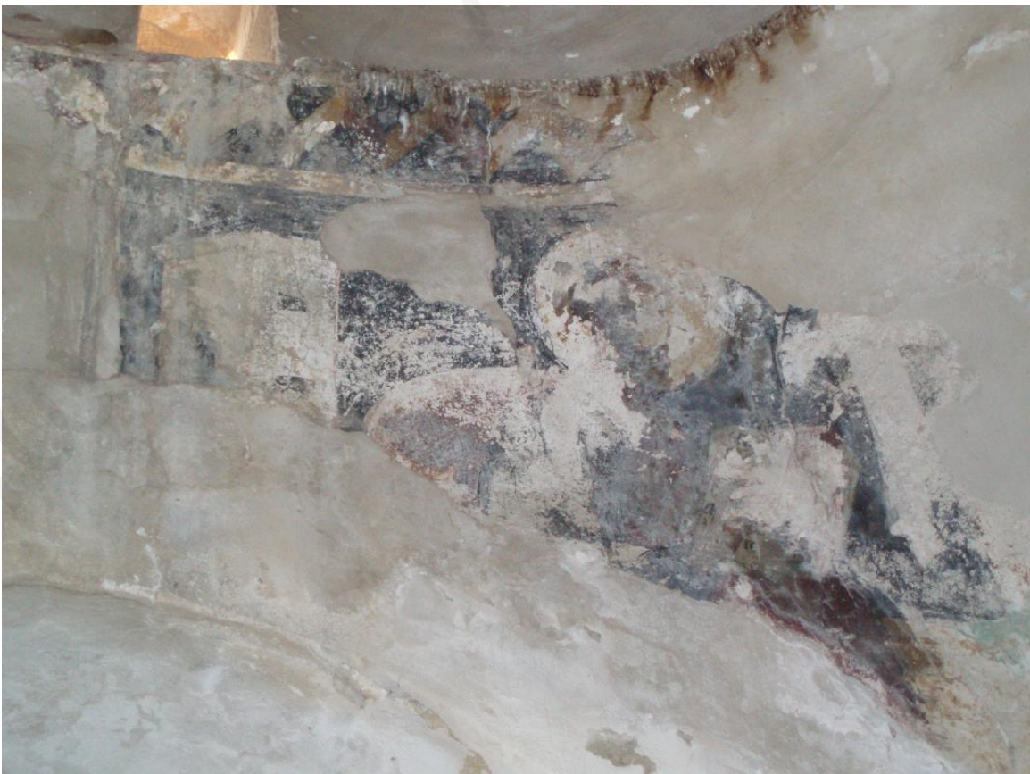
345γ. Λειβάδια Αμμοχώστου, Παναγία Κυρά, βόρεια πλευρά του τρούλλου, σφαιρικό τρίγωνο, αδιάγνωστος Ευαγγελιστής, α΄ μισό 16ου αιώνα
