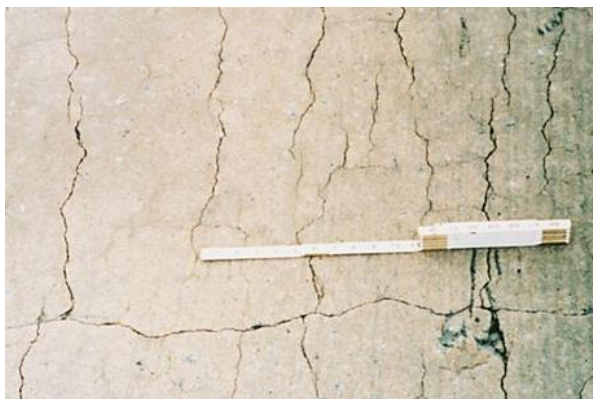
Εικόνα 3.8: Ρηγμάτωση σκυροδέματος λόγω αλκαλοπυριτικής αντίδρασης (Kosmatka et al., 2003).
