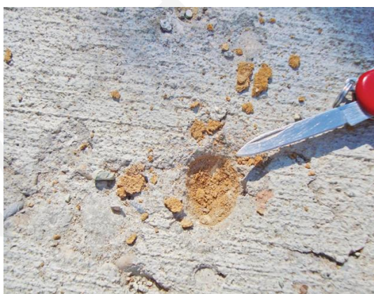
Εικόνα 3.6: Θρυμματισμός επιφανειακού μη "υγιούς" αδρανούς (Basham, 2013).
