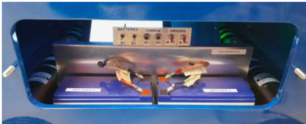
Σχήμα 3-24: Διακόπτες μπαταριών και motor driver από πλαϊνή θύρα πρωτότυπου ρομπότ
