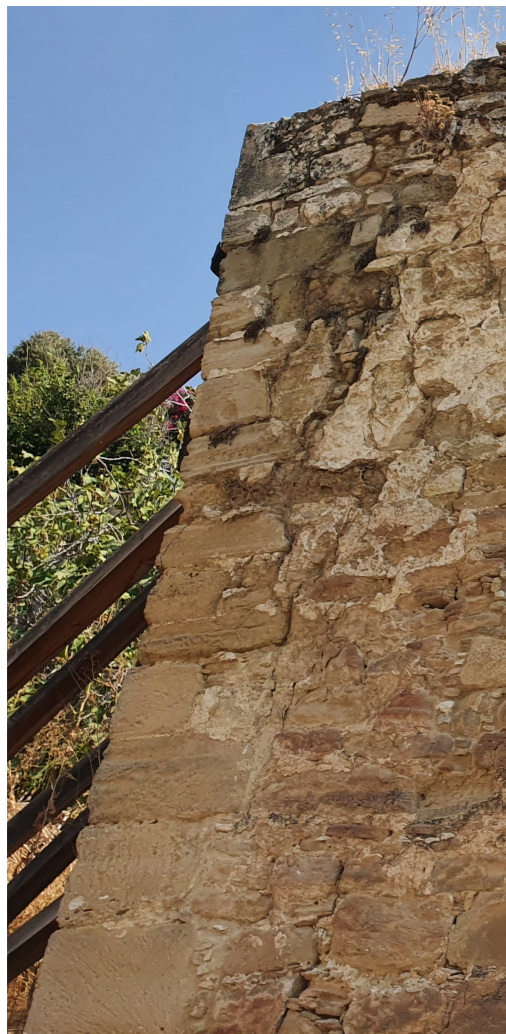
Εικ.45 Κάθετη ρωγμή στη δυτική τοιχοποιία
