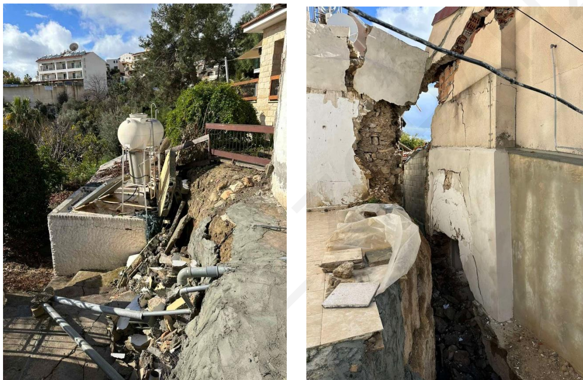
Σχήμα 10&11: Η μετακίνηση συνεχίζεται προκαλώντας μεγαλύτερες ζημιές, Ιανουάριος 2023. Πηγή: Τμ. Γεωλογικής Επισκόπησης
