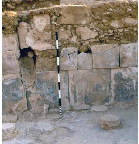
Εικ. 193: Κυλινδρικός αεραγωγός στο νότιο τοίχο του tepidarium , λουτρό της Οικίας του Ορφέα, Νέα Πάφος (Δημήτριος Μιχαηλίδης).
