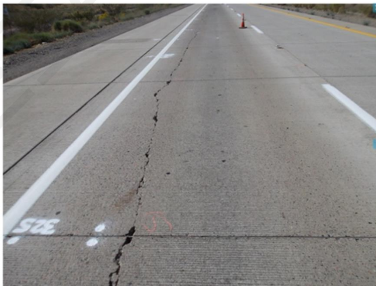
Εικόνα 10: Διαμήκειες ρωγμές κατά μήκος του οδοστρώματος.
