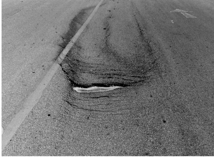
Εικόνα 14: Ρηγμάτωση λόγω ολίσθησης (Slippage cracking).
