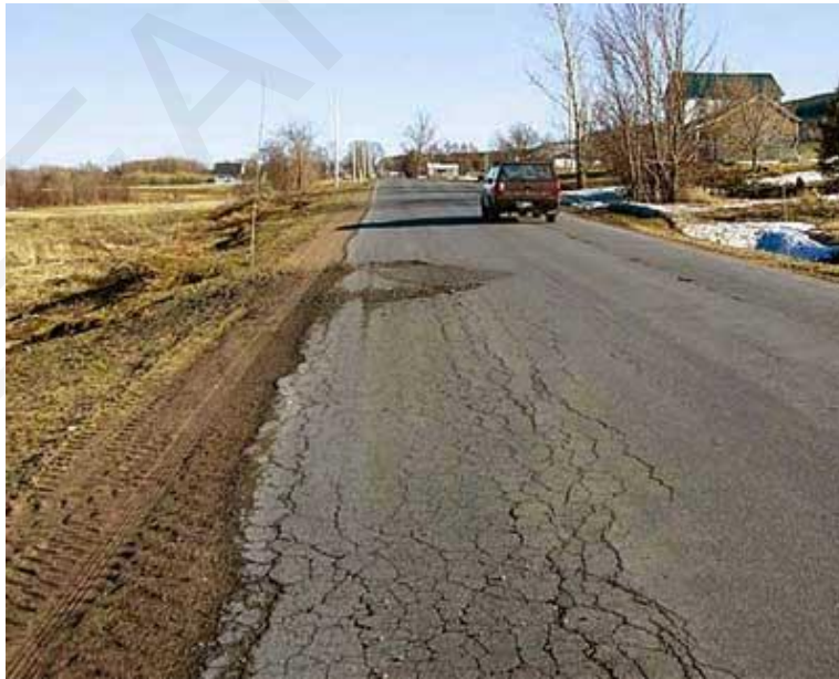
Εικόνα 15: Ρωγμές στα άκρα του οδοστρώματος (Edge Cracks).
