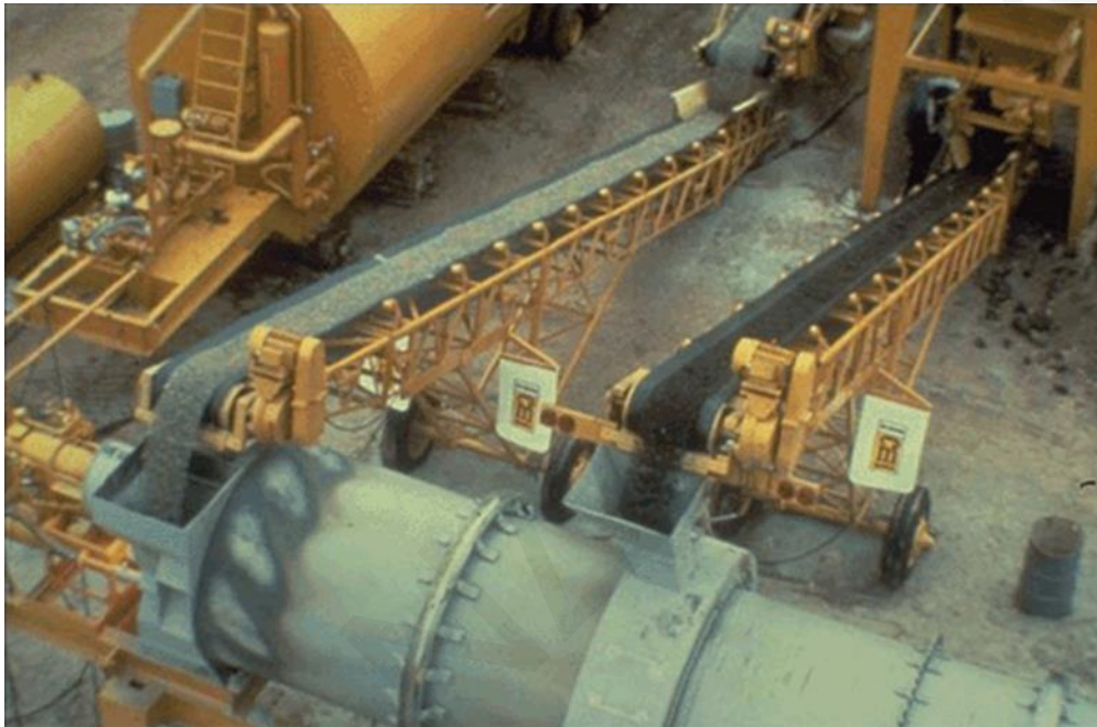
Εικόνα 1: Ανακύκλωση εν θερμώ.
