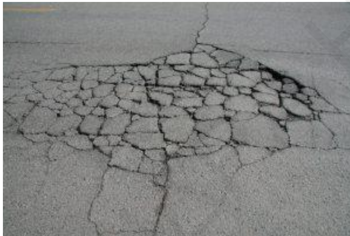
Εικόνα 5: Ρωγμές τύπου αλιγάτορα ή ρωγμές κόπωσης.
