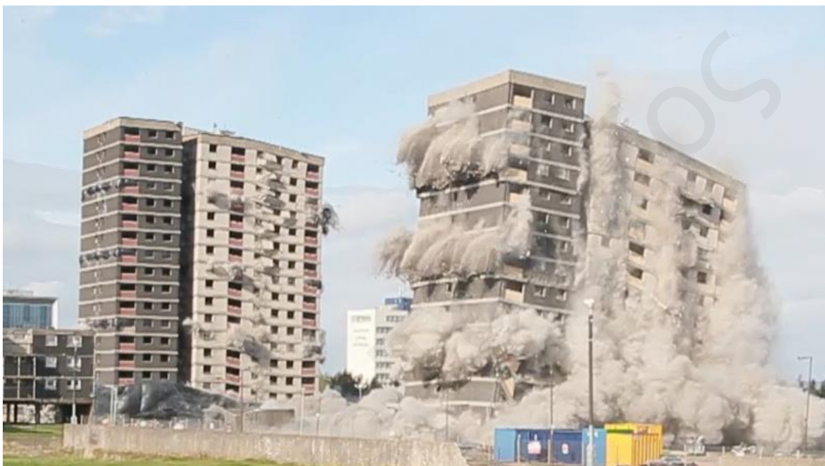
Εικόνα 4: Κατεδάφιση με εκρηκτικά μέσα (2020, https://www.designingbuildings.co.uk/wiki/Explosives )
