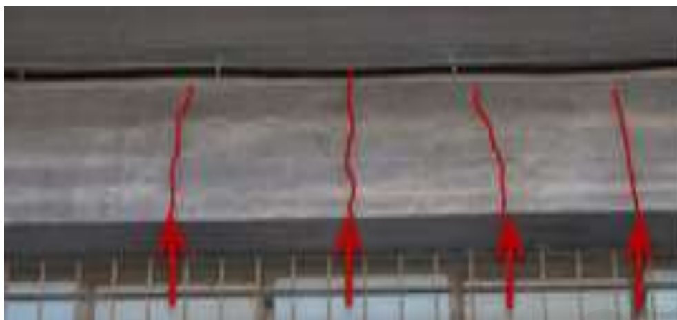
Εικόνα 3.19: Κάθετες ρωγμές κατά μήκος της δοκού
