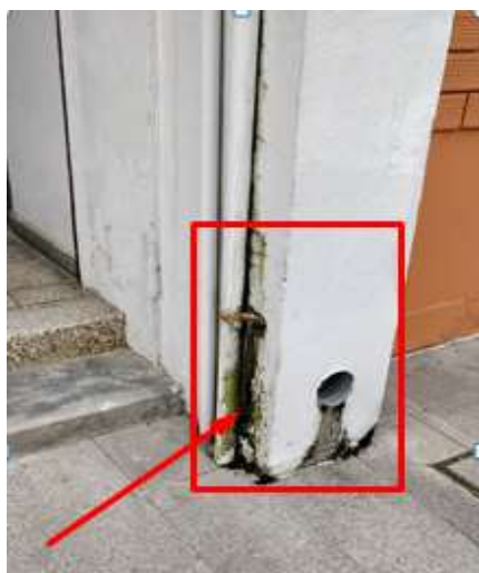
Εικόνα 3.13: Υδρορροή εισέρχεται μέσα από υποστύλωμα - έντονο φαινόμενο υγρασίας
