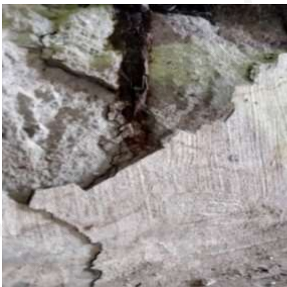
Εικόνα 3.11: Διάβρωση Οπλισμού - αποκόλληση επιχρίσματος
