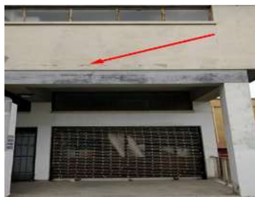
Εικόνα 3.18: Οριζόντιες ραγμές στο σημείο ένωσης του κάτω μέρους της τοιχοποιίας με τον φέροντα οργανισμό του κτιρίου
