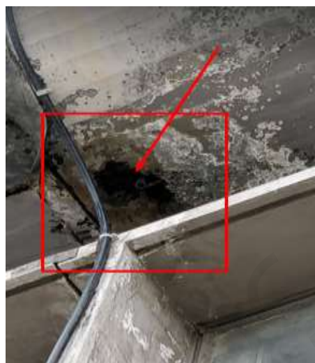
Εικόνα 3.14: Έντονο φαινόμενο υγρασίας σε πλάκα εσωτερικά του κτιρίου
