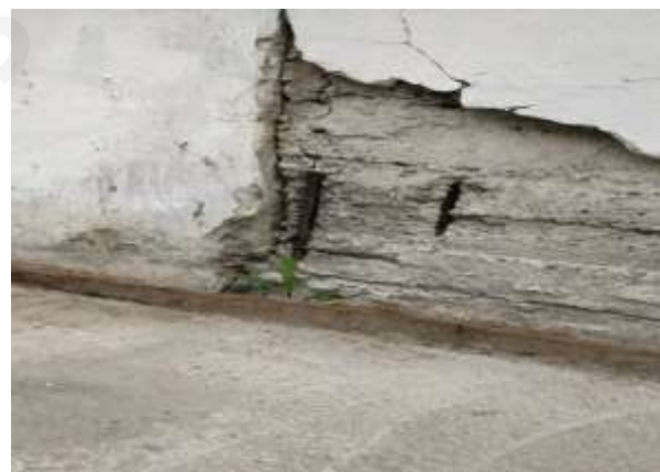
Εικόνα 3.12: Αποφλοίωση σκυροδέματος και εμφάνιση του οπλισμού
