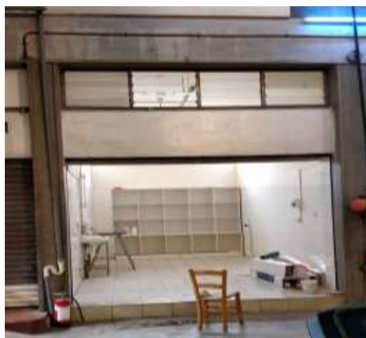
Εικόνα 3.21: Απουσία τοιχοποιίας εσωτερικά του κτιρίου
