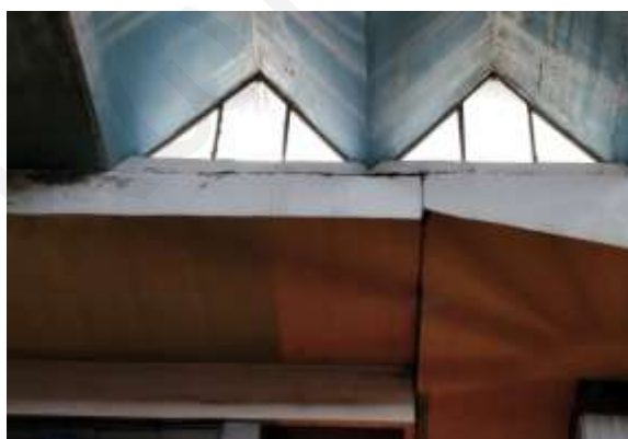
Εικόνα 3.17: Παραμόρφωση της πλάκας που βγαίνει σε πρόβολο
