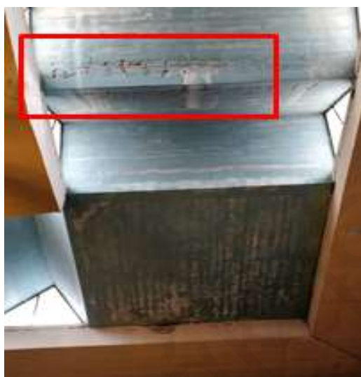
Εικόνα 3.15: Κακή επικάλυψη στο κάτω μέρος της πλάκας - Εμφάνιση του σπλισμού
