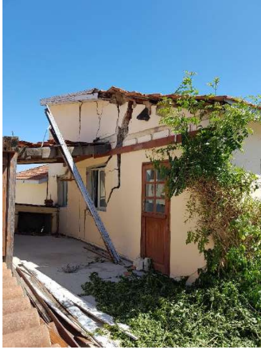
Σχήμα 1.11. Κατεστραμμένη κατοικία στο Πισσούρι.
