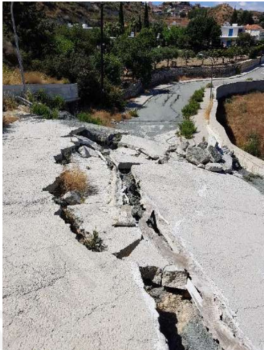
Σχήμα 1.13. Κατεστραμμένο τμήμα του οδικού δικτύου στο Πισσούρι.
