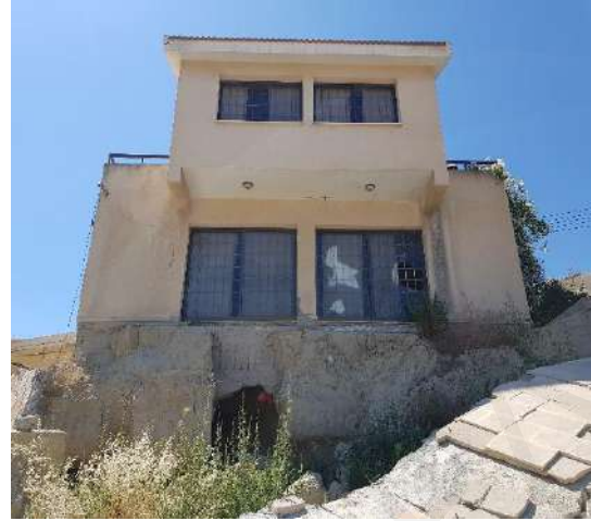
Σχήμα 1.16. Κατάρρευση τοίχου αντιστήριξης σε κατοικία, της οποίας μέρος της θεμελίωσης δεν στηρίζεται πλέον στο έδαφος.
