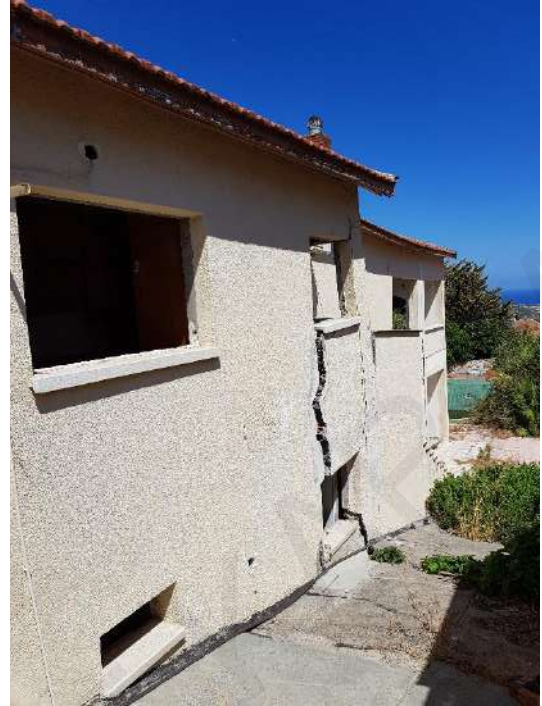
Σχήμα 1.12. Μεγάλες ρωγμές σε κατοικία στο Πισσούρι.
