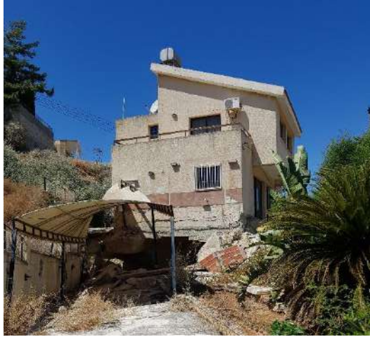
Σχήμα 1.15. Κατοικία με μέρος της θεμελίωσης να μην στηρίζεται πλέον στο έδαφος.
