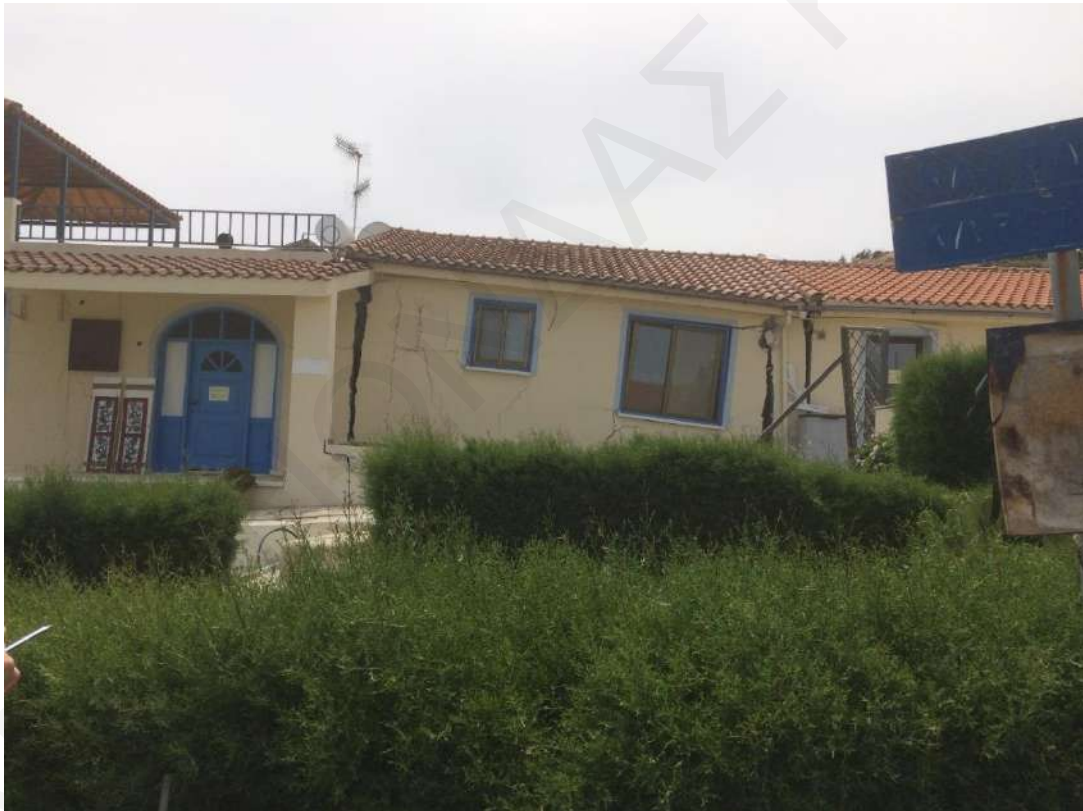
Σχήμα 1.17. Σημαντικές ζημιές και έντονες ρωγμές σε κατοικία που έχει πάρει κλίση.
