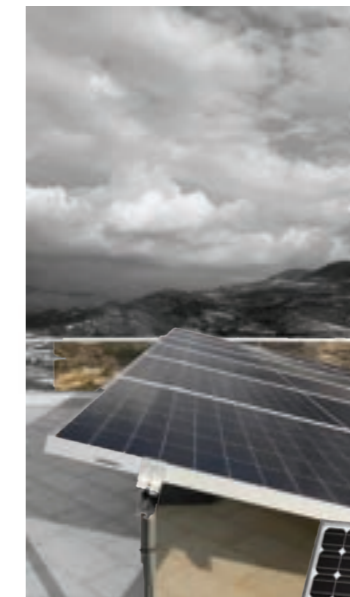
Φωτοβολταϊκά στην οροφή του τελευταίου επιπέδου που βοηθούν να καλυφθούν οι ηλεκτρικές ανάγκες του κτηρίου
