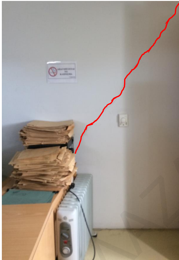
Σχήμα Α.7: Διαγώνια ρωγμή σε τοίχο πληρώσεως σε κτίριο αποθήκης που βρίσκεται στο βορειοανατολικό σύνορο της Πανεπιστημιούπολης του Πανεπιστημίου Κύπρου.
