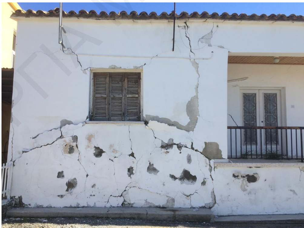
Σχήμα Α.8: Διαγώνιες ρωγμές σε τοίχο πληρώσεως σε οικία στην Αθηαίνου.
