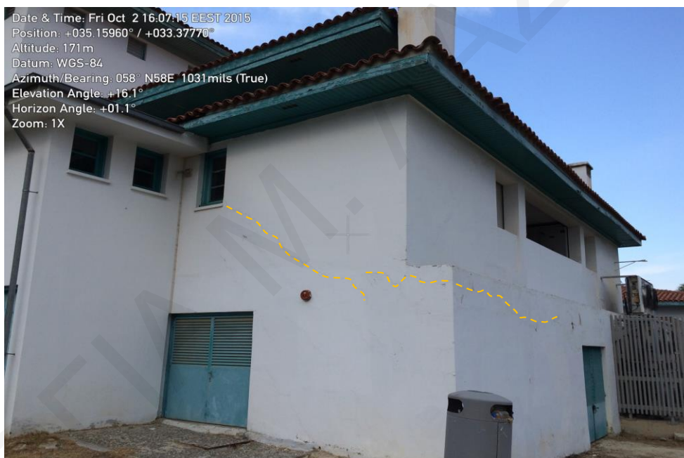
Σχήμα 2.1: Παράδειγμα αστοχίας σε κτίριο του παλαιού campus του Πανεπιστημίου Κύπρου.
