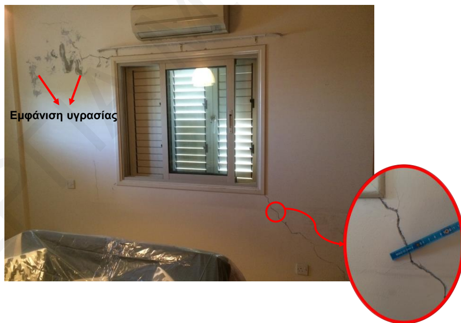
Σχήμα 2.3: Χαρακτηριστικές ρηγματώσεις και εμφάνιση υγρασίας σε τοίχο πληρώσεως σε οικία σε περιοχή της Λευκωσίας.
