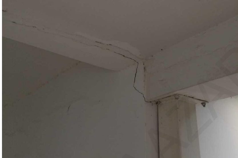
Σχήμα 2.2: Ρηγματώση δομικού στοιχείου σε κτίριο του παλαιού campus του Πανεπιστημίου Κύπρου.
