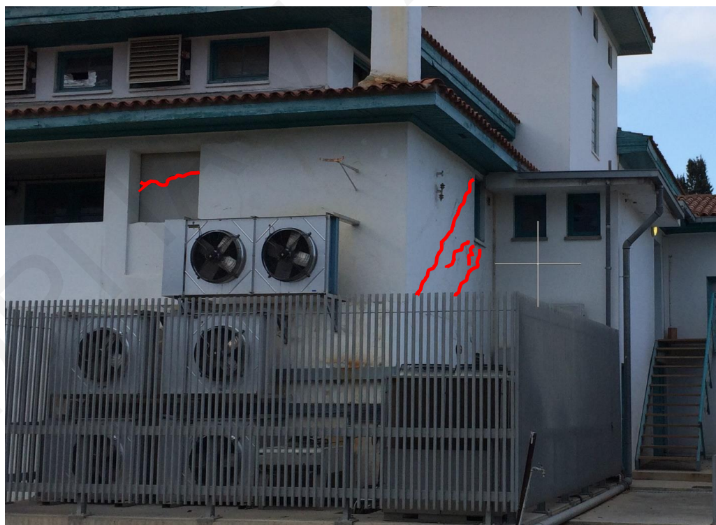
Σχήμα Α.4: Ρηγματώσεις τοίχων πλήρωσεως της αίθουσας τελετών στο παλαιό campus του Πανεπιστημίου Κύπρου το 2015 (το εν λόγω κτίριο κατεδαφίστηκε το 2016 και ανακατασκευάστηκε εκ θεμελίων).
