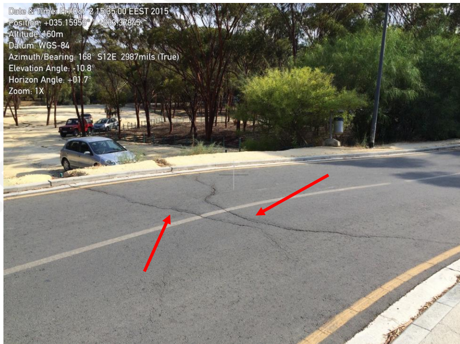
Σχήμα Α.2: Ρηγματώσεις στο οδόστρωμα στους χώρους του παλαιού campus του Πανεπιστημίου Κύπρου.
