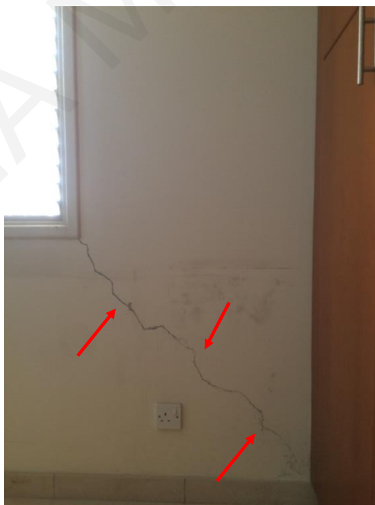
Σχήμα Α.6: Διαγώνια ρωγμή στον τοίχο πληρώσεως σε διώροφο κτίριο στη Λευκωσία.
