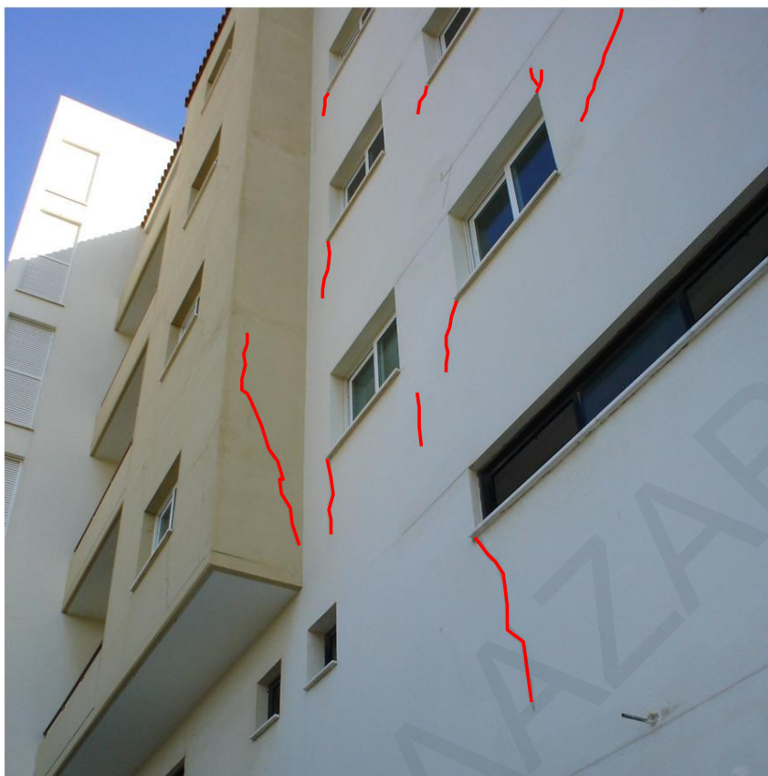
Σχήμα Α.5: Ανάπτυξη διαγώνιων ρωγμών στους τοίχους πληρώσεως 6-όροφου κτιρίου στη Λευκωσία.
