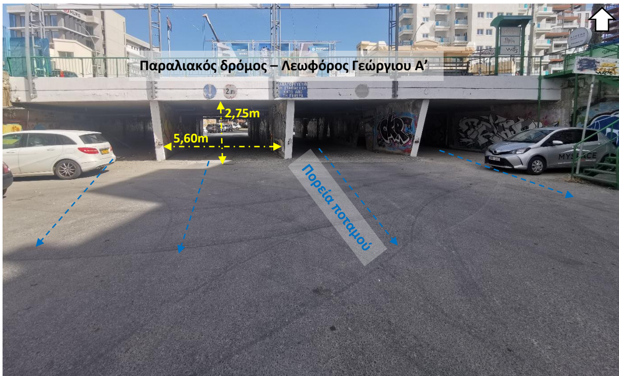
Φωτογραφία 5: Άποψη της γέφυρας που βρίσκεται στην έξοδο του ποταμού από την περιοχή ανάπλασης (Παραλιακός δρόμος) που αποτελείται από 4 ορθογωνικούς οχετούς διαστάσεων 5,60m πλάτους και 2,75m ύψους (προσανατολισμός φωτογραφίας: προς βόρεια)
