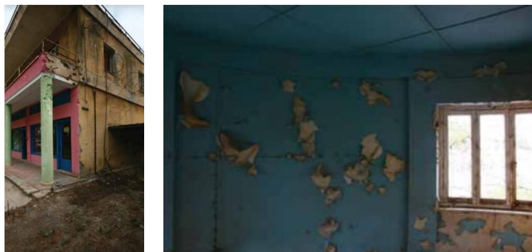
Εικόνα 3.4: Ερήμωση και καταστροφή του κτιρίου
