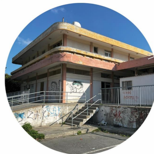
4. Εγκαταλελειμένος χώρος κοινοτικού ιατρείου. Το κτίριο λόγω της υψομετρικής διαφοράς που έχει από τον δρόμο καθιστά την επιτήρηση του δύσκολη και έτσι έχει παραβιαστεί από νεαρούς του συνοικισμού.
